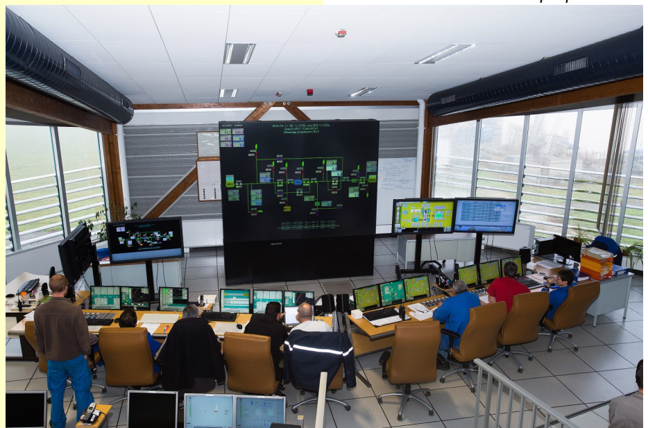
Fig. 2 - Salle de commande TRIPODE, © DGA Essais propulseurs.
