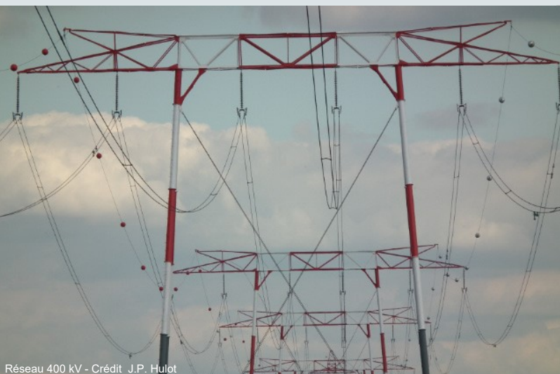
Réseau 400 kV - Crédit J.P. Hulot
