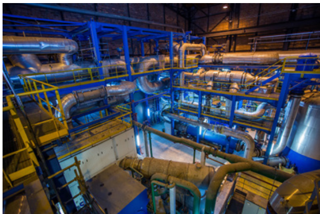
Figure 2 : BU1 - Unité de conditionnement d'air en alimentation
